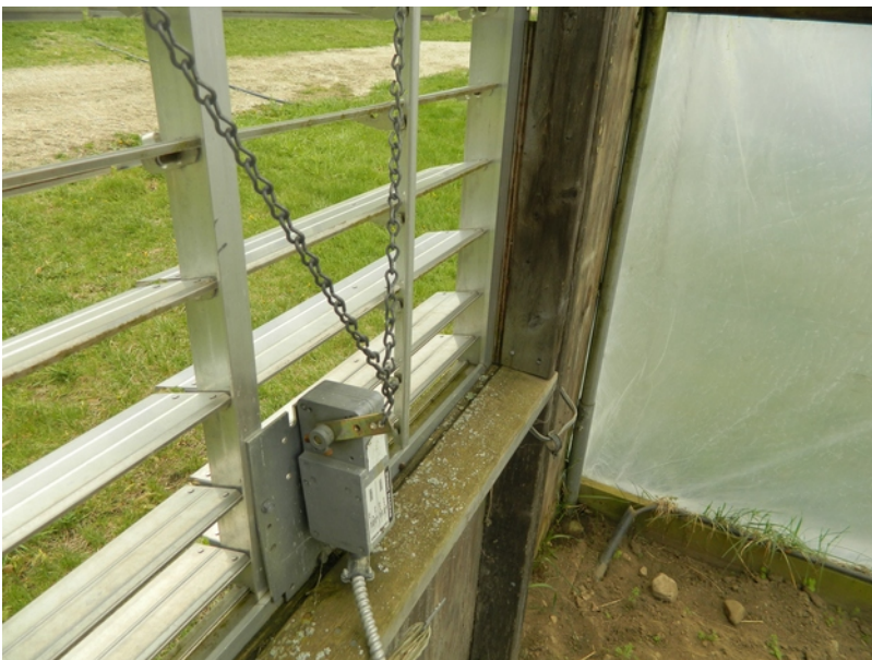
Afbeelding 59: Louvre raam in kas dat met elektrische bediening geopend en gesloten kan worden. Vorm van passieve ventilatie.
