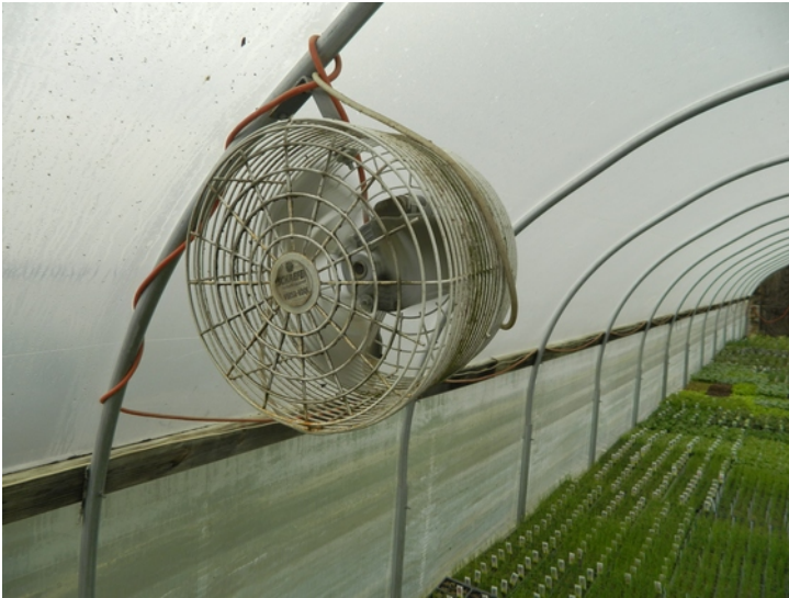
Afbeelding 63: Ventilator in kas
