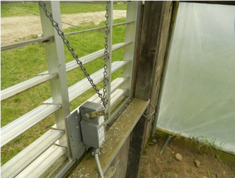
Afbeelding 44: Louvre raam in kas dat met elektrische bediening geopend en gesloten kan worden. Vorm van passieve ventilatie.
