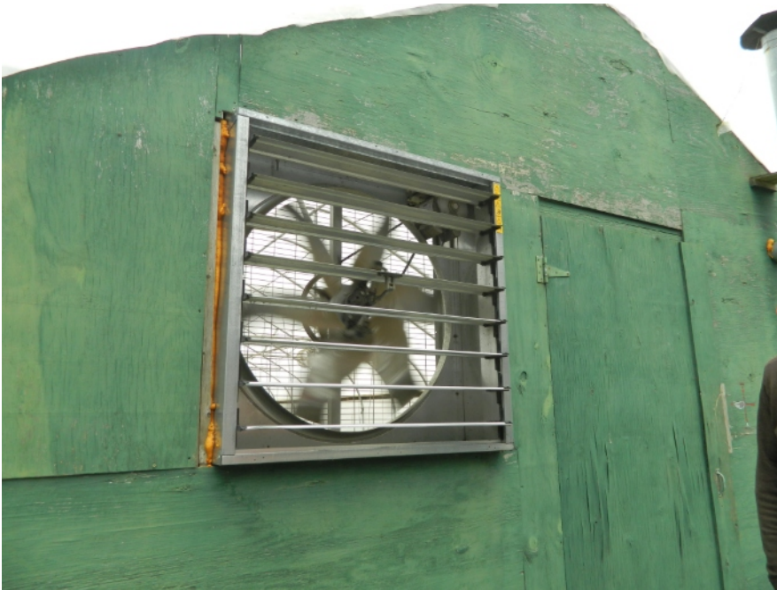
Image 64: Louvre shutters met ingebouwde ventilator
