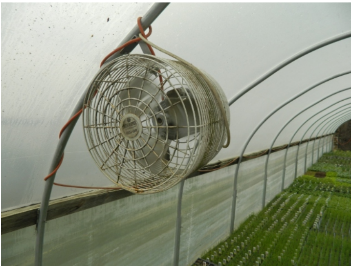
Afbeelding 65: Ventilator in kas
